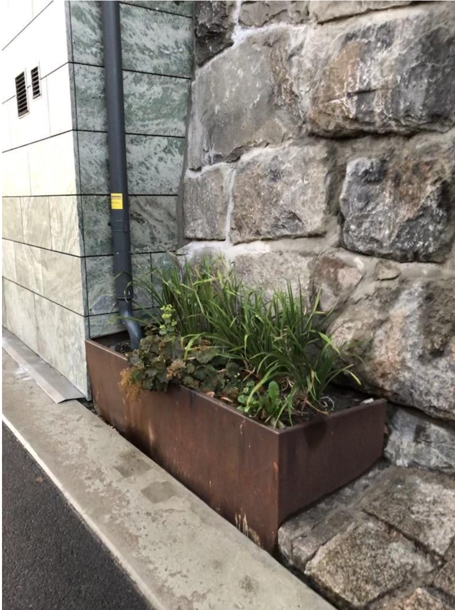
Figur 28. Upphöjda regnbäddar som avleder takvattnet via stuprör. Bild Sweco.
